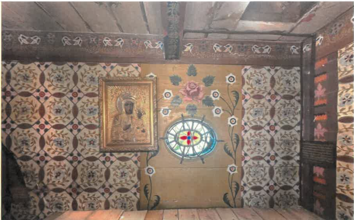
Fot.25. Kościół parafialny pw. św. Jakuba Apostoła i Katarzyny Aleksandryjskiej w Raciechowicach. Widoczne ściany w części zachodniej świątyni na chórze. Eksponowana polichromia jest wynikiem przemalowana „po formie”, wykonanym najpewniej w latach 80 tych XX w. Pierwotną dekorację malarską wykonano w latach 30 XX w. przez S. Wymiatałką z Wieliczki. Stan przed konserwacją. Fot. Joanna Babraj- Mędrała 2024.
