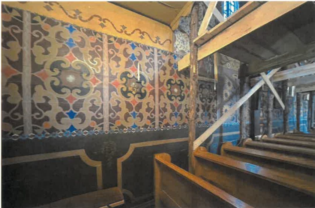
Fot.23. Kościół parafialny pw. św. Jakuba Apostoła i Katarzyny Aleksandryjskiej w Raciechowicach. Widoczny fragment północnej ściany nawy. Eksponowana polichromia jest wynikiem przemalowana „po formie”, wykonanym najpewniej w latach 80 tych XX w. Pierwotną dekorację malarską wykonano w latach 30 XX w. przez S. Wymiatałką z Wieliczki. Stan przed konserwacją. Fot. Joanna Babraj- Mędrała 2024.
