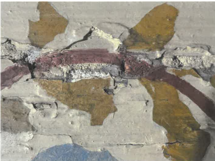
Fot.45. Kościół parafialny pw. św. Jakuba Apostoła i Katarzyny Aleksandryjskiej w Raciechowicach. Widoczny fragment dekoracji ornamentalnej ścian nawy. Notujemy ubytki pierwotnej polichromii do drewna, które zostały przemalowane bez przeprowadzenia uzupełnień warstwy gruntu. Całość spękana, wykazująca tendencję do odspajania. Stan przed konserwacją. Fot. Joanna Babraj- Mędrala 2024.
