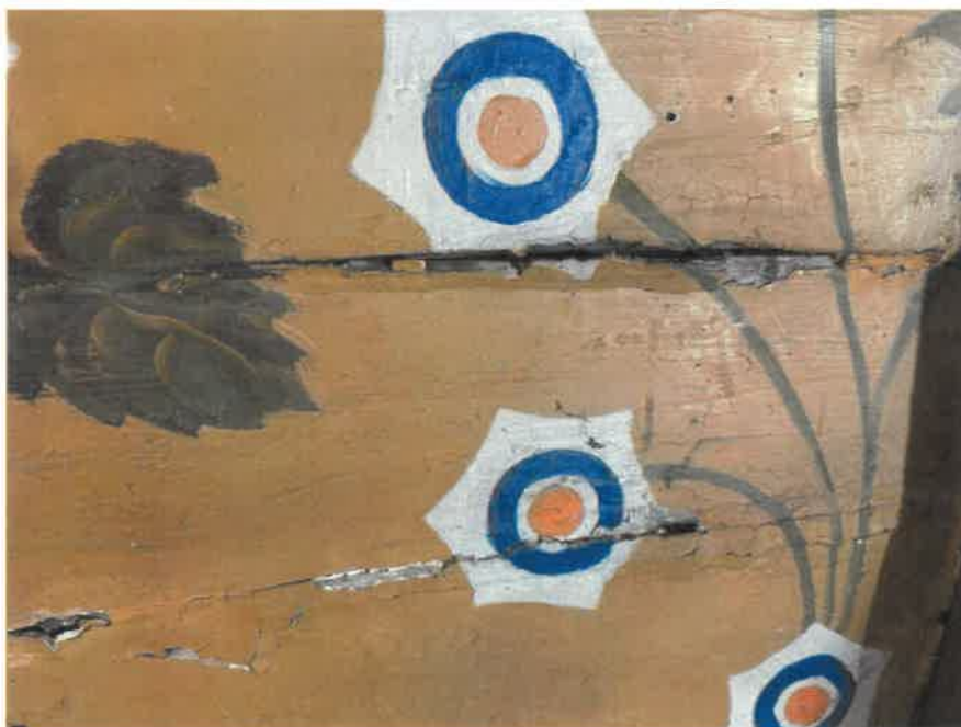
Fot.37. Kościół parafialny pw. św. Jakuba Apostoła i Katarzyny Aleksandryjskiej w Raciechowicach. Widoczny fragment dekoracji ornamentalnej ścian nawy. Notujemy poważne spękania warstwy malarskiej ponadto widoczne ubytki masy uzupełniającej między deskowaniem ściany. Stan przed konserwacją. Fot. Joanna Babraj- Mędrala 2024.
