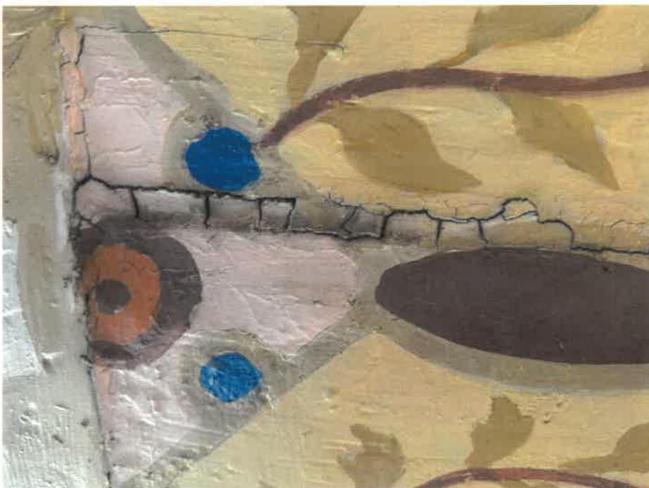
Fot.43. Kościół parafialny pw. św. Jakuba Apostoła i Katarzyny Aleksandryjskiej w Raciechowicach. Widoczny fragment dekoracji ornamentalnej ścian nawy. Notujemy poważne spękania warstwy malarskiej ponadto widoczne ubytki masy uzupełniającej pomiędzy deskowaniem ściany. Stan przed konserwacją. Fot. Joanna Babraj- Mędrała 2024.
