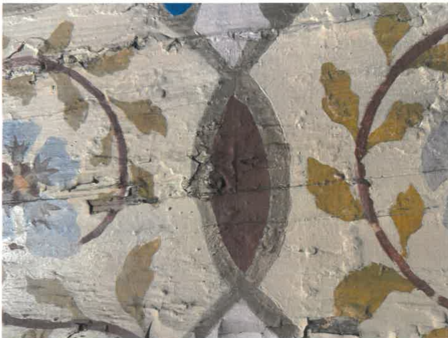
Fot.42. Kościół parafialny pw. św. Jakuba Apostoła i Katarzyny Aleksandryjskiej w Raciechowicach. Widoczny fragment dekoracji ornamentalnej ścian nawy. Notujemy poważne spękania warstwy, ubytki do poziomu drewna. Całość polichromii podlega również łuszczeniu i odpajaniu od drewnianego podobrazia. Stan przed konserwacją. Fot. Joanna Babraj- Mędrała 2024.
