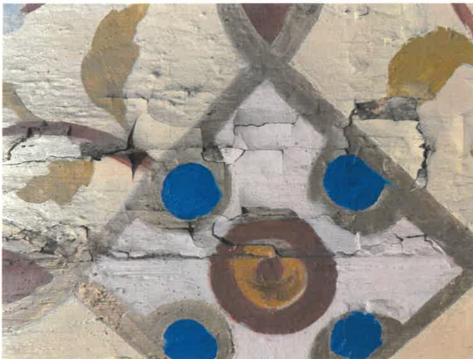
Fot.36. Kościół parafialny pw. św. Jakuba Apostoła i Katarzyny Aleksandryjskiej w Raciechowicach. Widoczny fragment dekoracji ornamentalnej ścian nawy. Notujemy poważne spękania warstwy malarskiej przechodzące przez wszystkie warstwy technologiczne aż do poziomu drewna. Całość podlega również łuszczeniu i odpajaniu od drewnianego podobrazia. Stan przed konserwacją. Fot. Joanna Babraj- Mędrala 2024.
